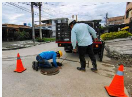
DAÑO TUBERÍA DE GRESS – LAS VILLAS
