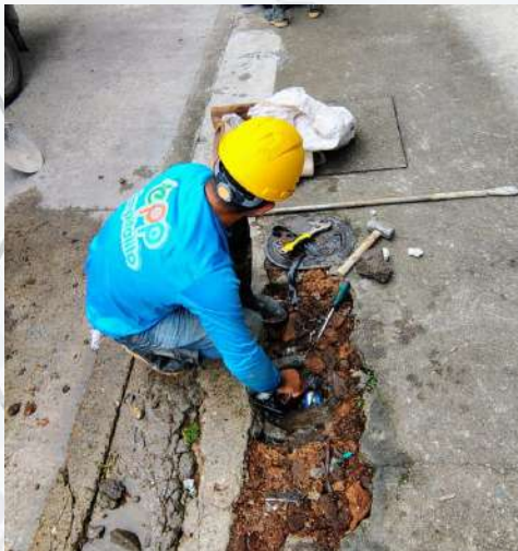
FUGA –AGUA BLANCA
