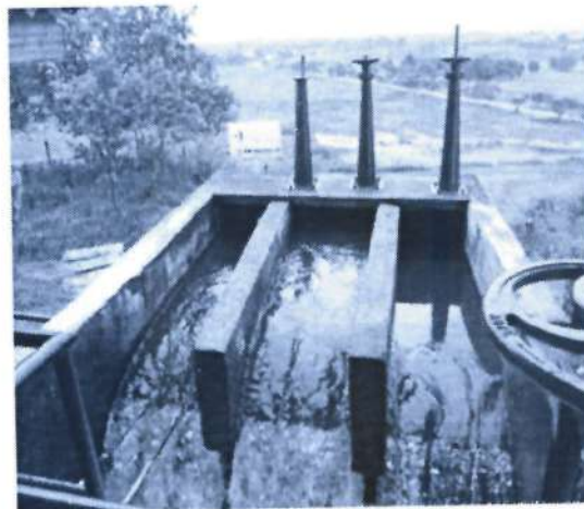
Figura 2.16. Cámara de Llegada
