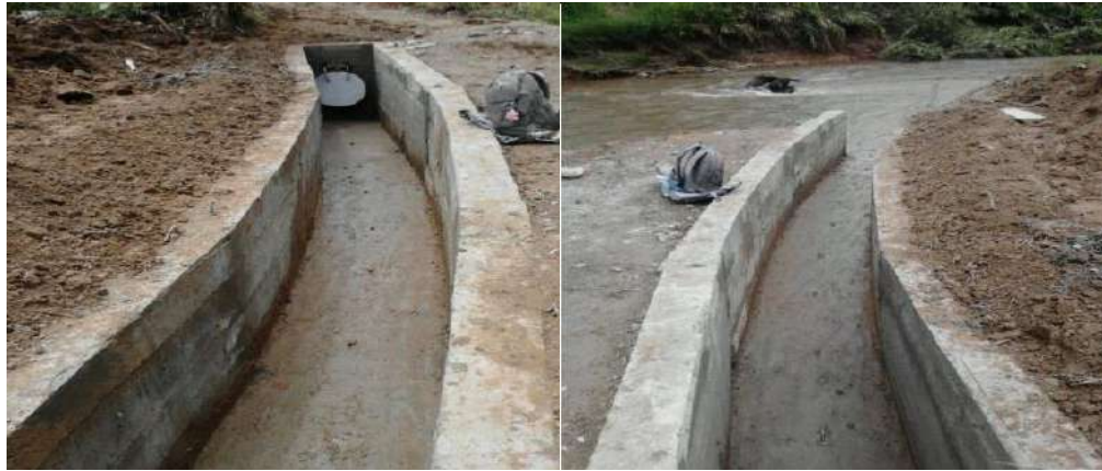
Ilustración 15 Aliviadero aguas lluvias zanjón de los Tiestos Fuente: consorcio aguas del Huila
