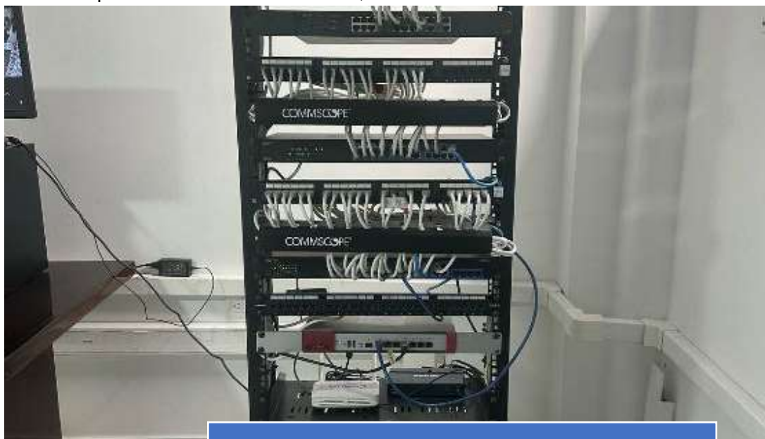
Centro de red cableada
